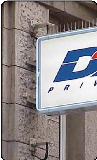
Kaum zu entdecken: eine Mikrozelle an der Hauswand ober- und unterhalb des Reklameschildes.
